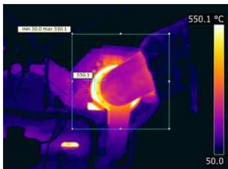
Obr. 6 Kogenerační jednotka masivní tepelné ztráty (teplota 550 °C)
