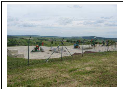
Obr. č. 5 Plošina s těžebními pumpami
