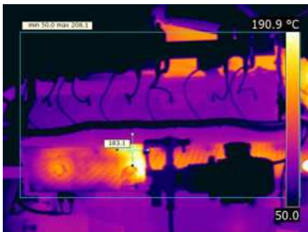
Obr. 5 Kogenerační jednotka tepelné ztráty
