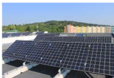
Fig. 2 The photovoltaic power station Kamínky (Photo: Doskočilová)
